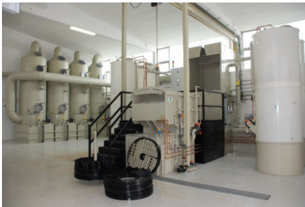
Abluftanlage mit Abwasserreinigungsanlage | Absorber system with waste water treatment
