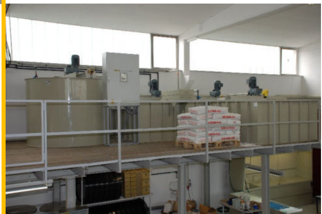
Behälter einer Abwasserreinigungsanlage | Tanks of a waste water treatment system
